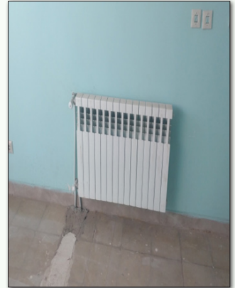
● بازسازی لوله‌کشی مربوط به رادیاتورها
