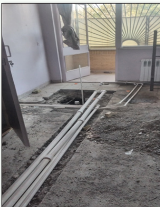
● لوله‌کشی رادیاتورها طبقه همکف
