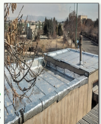
● سقف سرویس‌های بهداشتی جنب سلف
