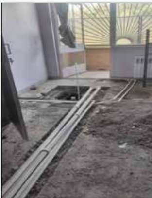
● لوله‌کشی رادیاتورها طبقه همکف
