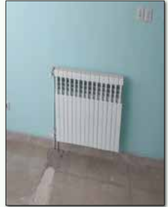
● بازسازی لوله‌کشی مربوط به رادیاتورها
