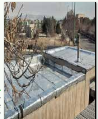
● سقف سرویس‌های بهداشتی جنب سلف
